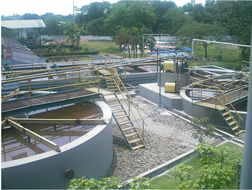
Gambar 5.18. Instalasi Pengolahan Air Limbah (IPAL)
